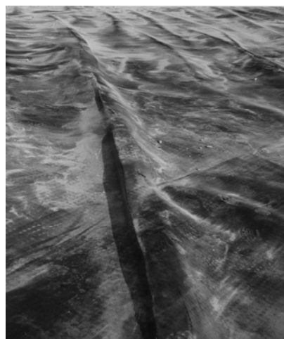
Abbildung 5: Aufgrabung einer stark wellig verlegten KDB (Quelle: R. Schicketanz.)
